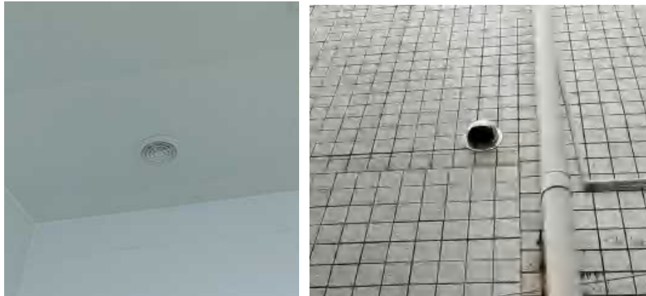
图 3-6 项目机房通风系统现场照片
