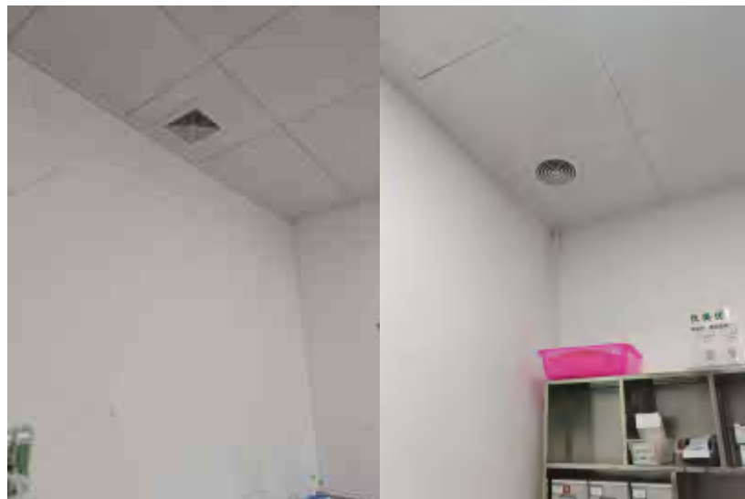
项目东面排气口
