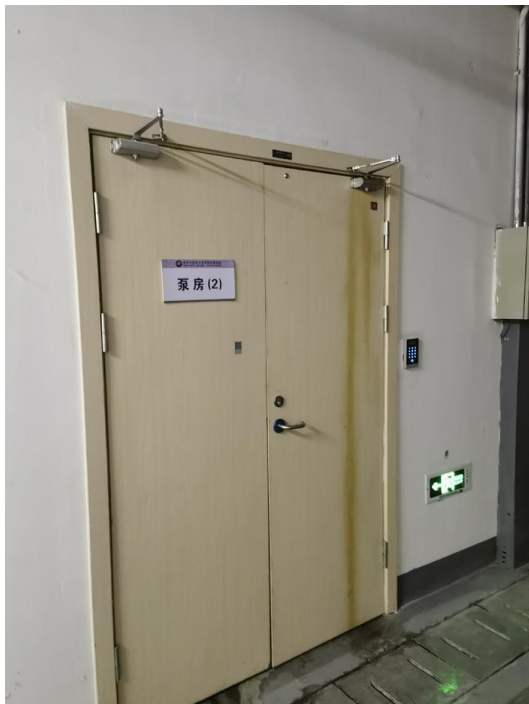
楼下生活水泵房
