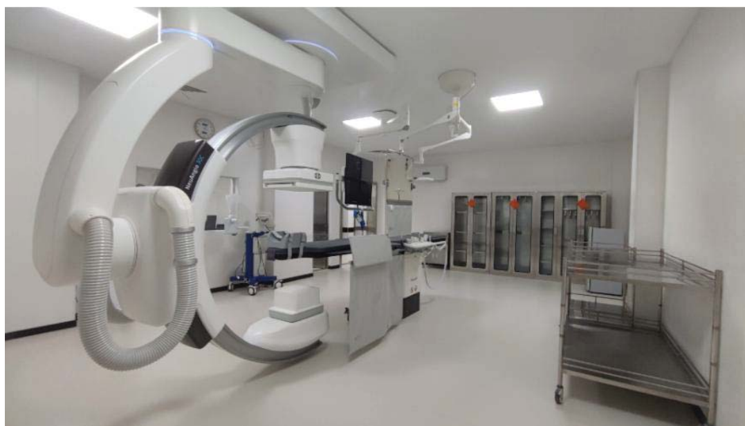
机房内部布局
