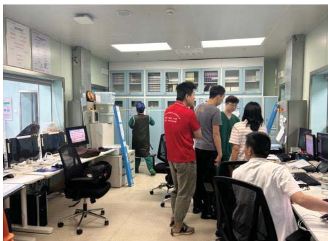
西北侧：控制室
