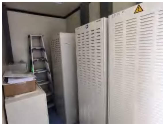
DSA 机房南侧设备间
