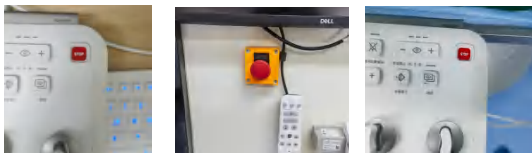
图 3-6 DSA 操作台、操作室墙面和设备床旁急停按钮
