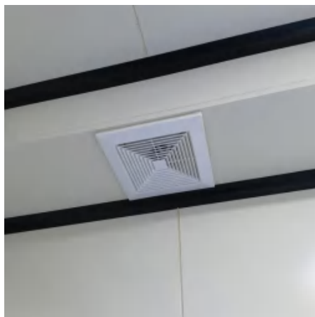
图 3-4 DSA 机房内机械排风扇
