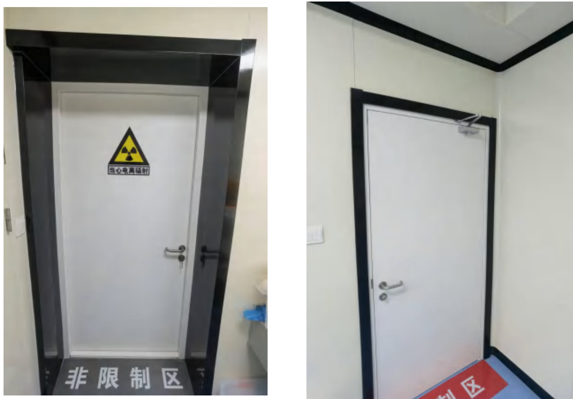
污物通道防护门电离辐射警示标识和闭门装置
