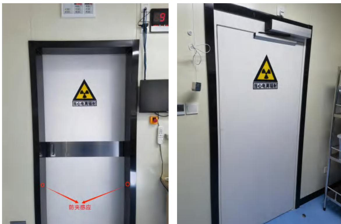
工作人员防护门（电动移门） 电离辐射警示标识及防夹
